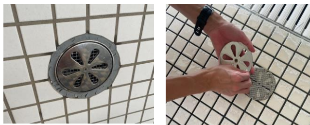
プール給水口
