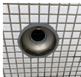
アクアサーキット プール給水口
